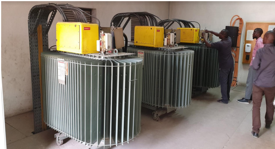
Illustration : transformateurs existants
